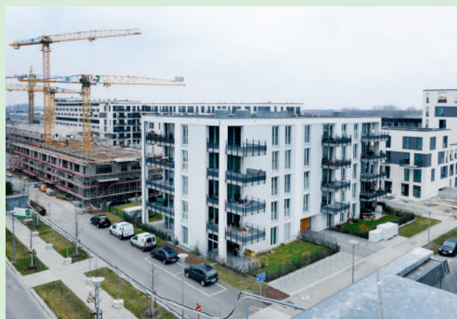
Ideal für das innovative Energiekonzept: Die Häuser im Neubaugebiet weisen einen geringen Energiebedarf auf.
